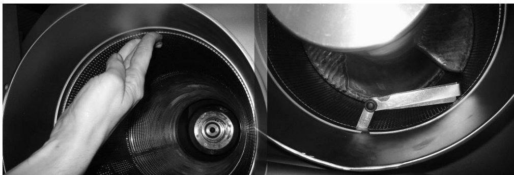
Abb.13-11: Bewegliches Sieb im Separator, Prüfung der Schwimmfähigkeit mit der Hand (links)
